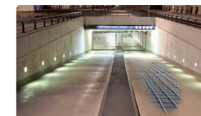
Rampa de acceso a garaje calefactada.
