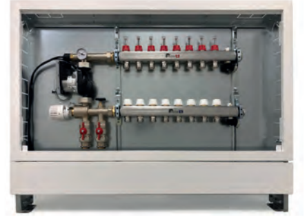
Caja con colector y grupo hidráulico compacto.
