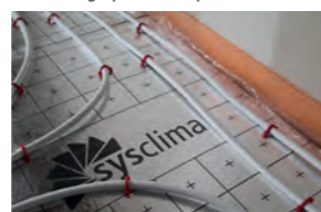
Instalación con tubo multicapa Sysclima y placa ALU-PG-TA.
